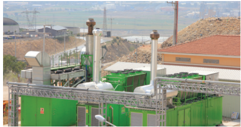
LFG, Metan gazından elektrik enerji üretim tesisi
